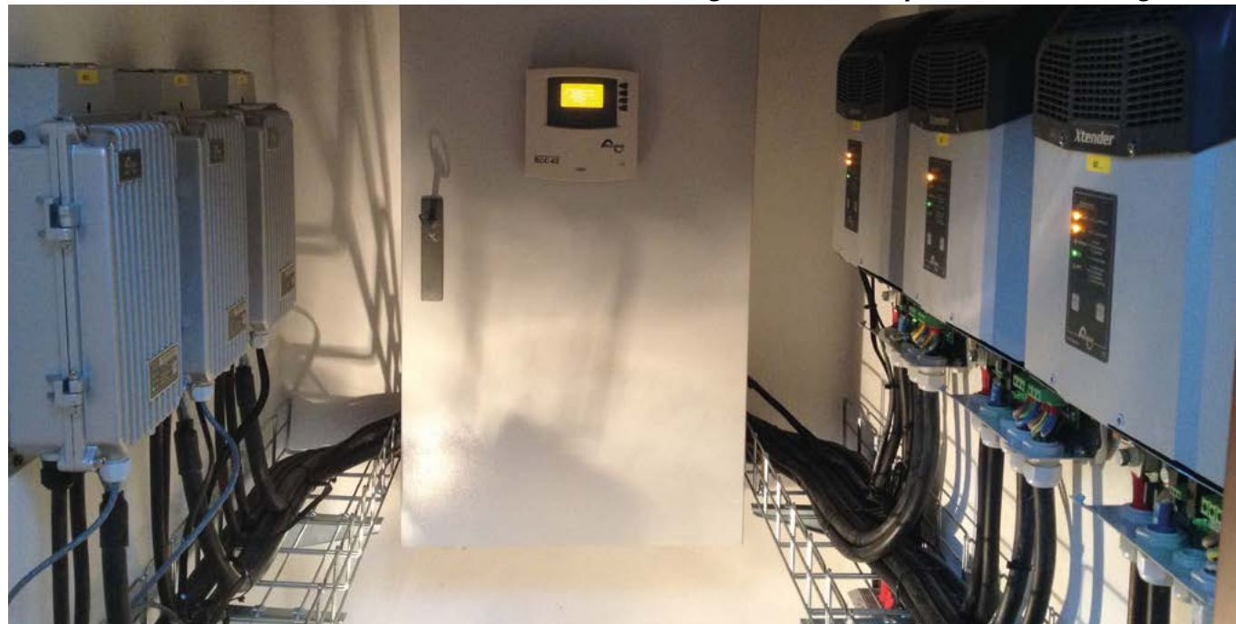
Eigenverbrauchssystem für Industriegebäude
