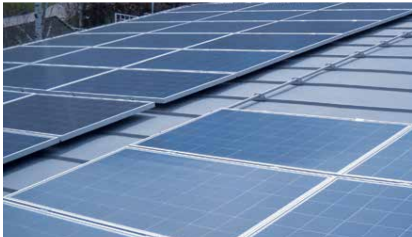
Elpo | Bruneck - Italien Anlage: 66,24 kW | Blechfalz mit S5!
