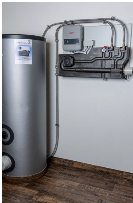
Platzsparend und übersichtlich: Installation im Heizungskeller.
